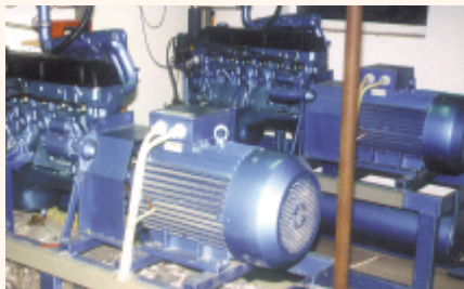
BHKW-Modul mit Asynchron-generator und Abgaswärmtauscher
